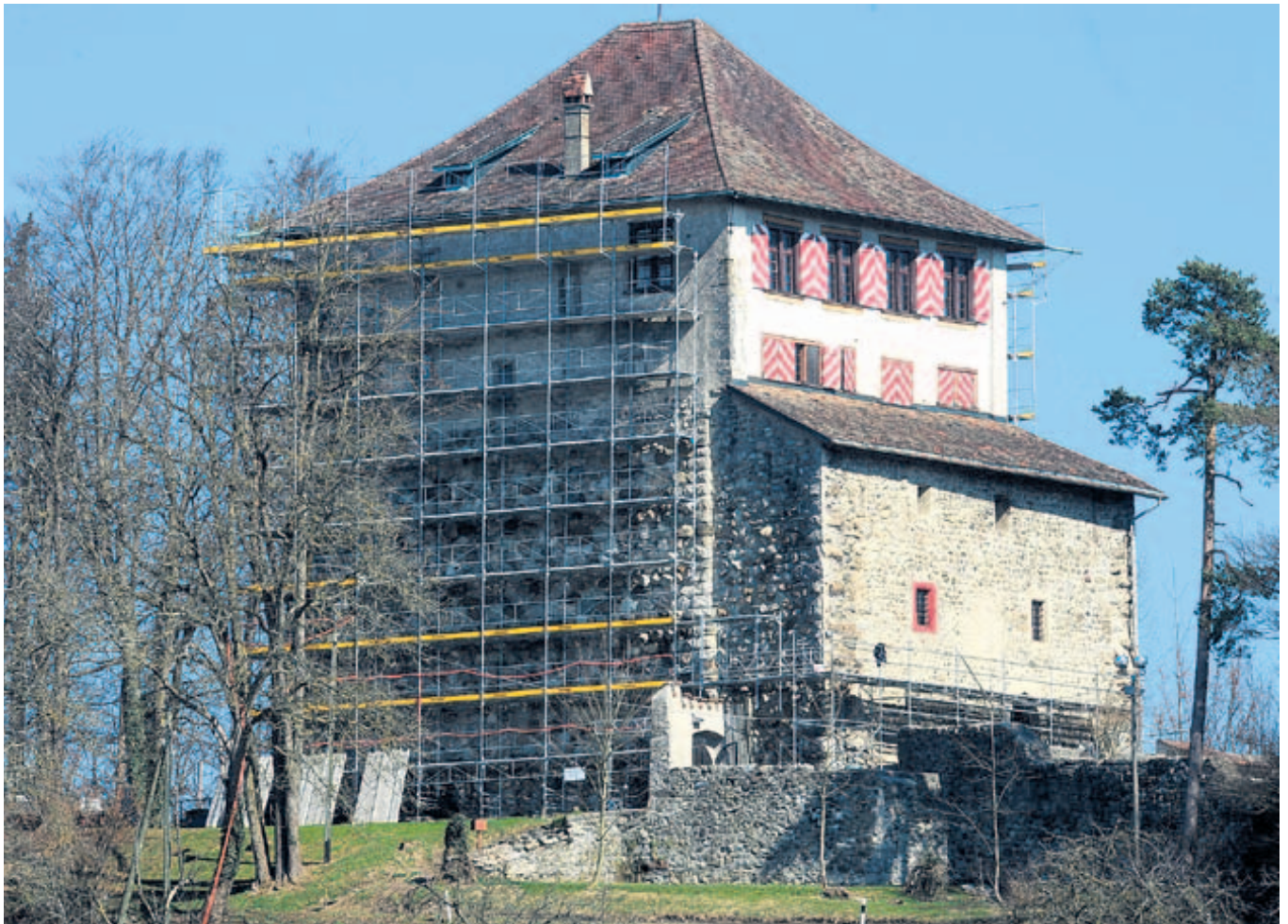
Ein Teil des Gerüsts für die Arbeiten an der Mörzburg steht schon. Bis im Sommer soll es möglichst wieder verschwinden, damit die Burg als Theaterkulisse etwas hermacht. Bild: hd
